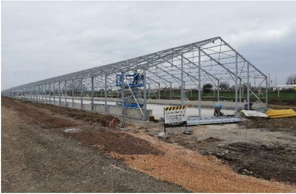
Lüleburgaz solar çamur kurutma tesisi
