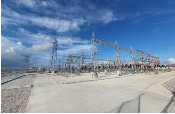
Babaeski Trafo Merkezi
