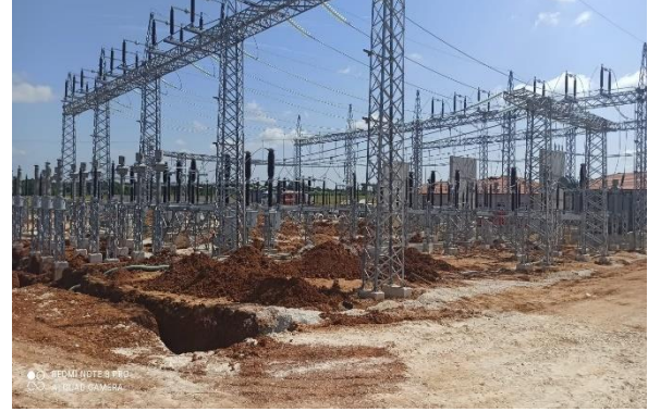
Pagder Aslan OSB Trafo Merkezi
