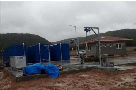
Kıyıköy paket atıksu arıtma tesisi
