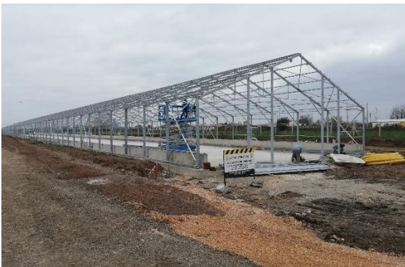
Lüleburgaz Solar Çamur Kurutma Tesisi
