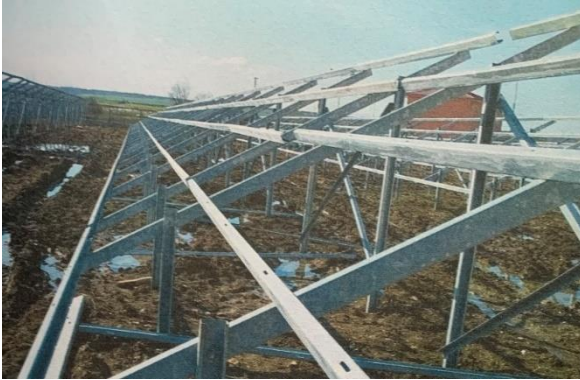
Pınarhisar güneş enerji santrali
