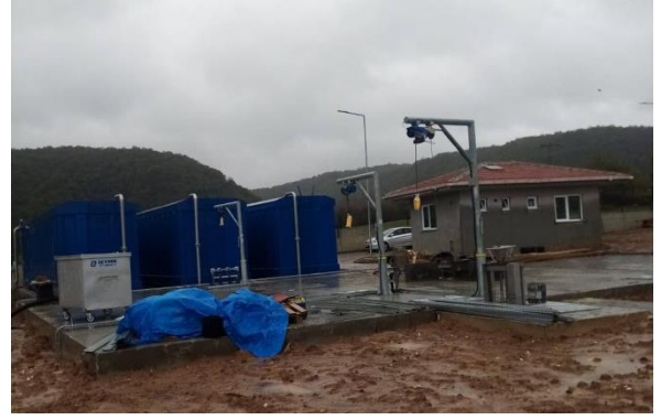
Kıyıköy paket atıksu arıtma tesisi
