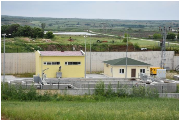
Büyükmandıra-Büyükkarıştıran Atıksu Arıtma
