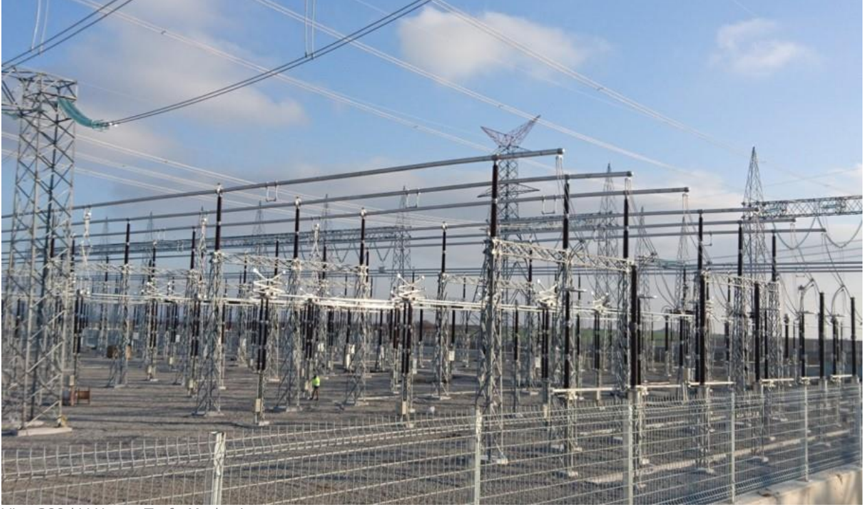
Vize 380 kV Havza Trafo Merkezi
