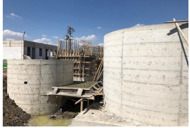
Alpulu Atıksu Arıtma Tesisi
