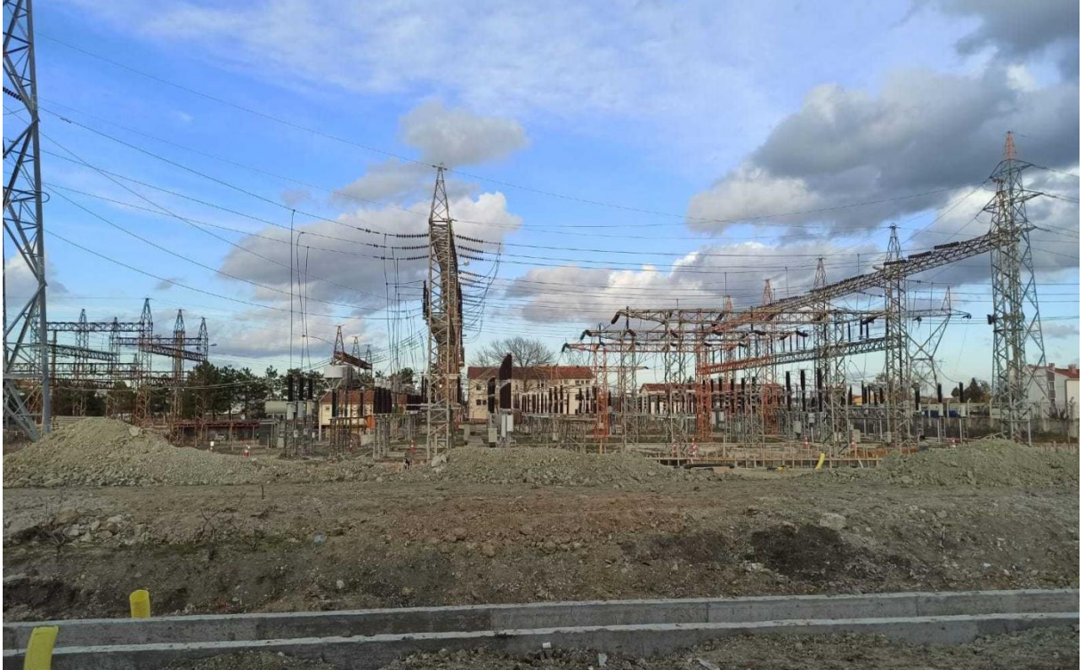
Babaeski Trafo Merkezi (11.12.2020)
