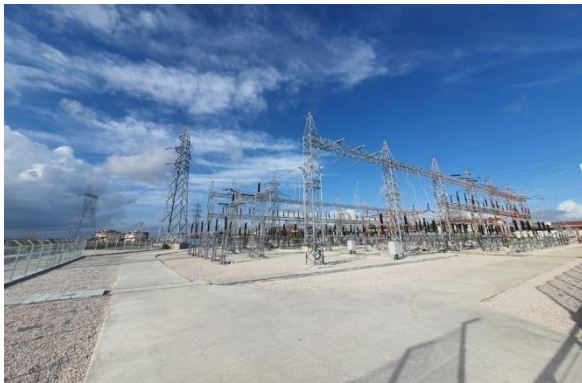
Babaeski Trafo Merkezi
