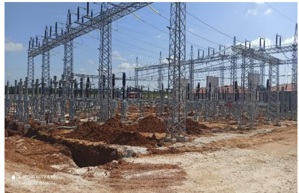
Pagder Aslan OSB Trafo Merkezi
