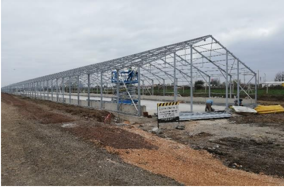
Lüleburgaz solar çamur kurutma tesisi
